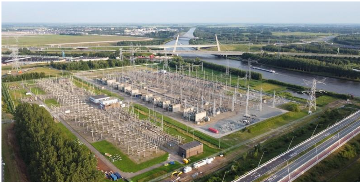
Figuur 1: afbeelding van een 380/150kV openluchtinstallatie (AIS-station)
